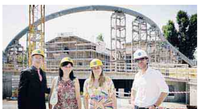
Nella foto della visita al cantiere, da sinistra Diego Giolitti del Museum of London, Adriana Zini, Maja Argenziano e Andrea Morgante
